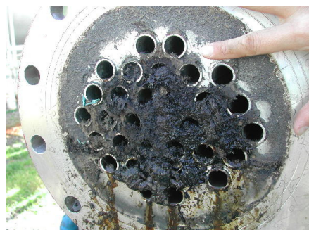
図4 消化液が循環温水に進入したと思われるフィード加温機の内部の状況
