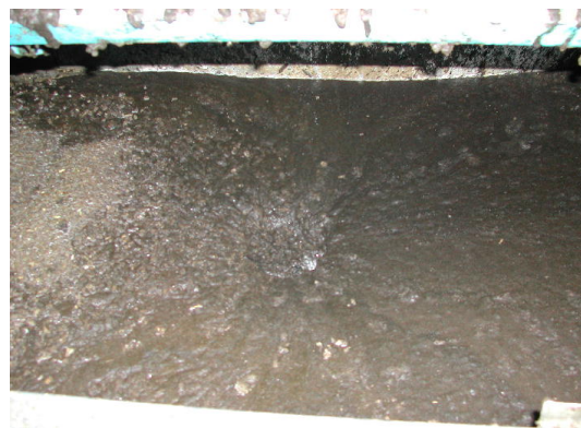
凍りついた液分回収ホースへの入口
