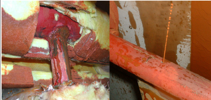
図1 温水漏れの状況
