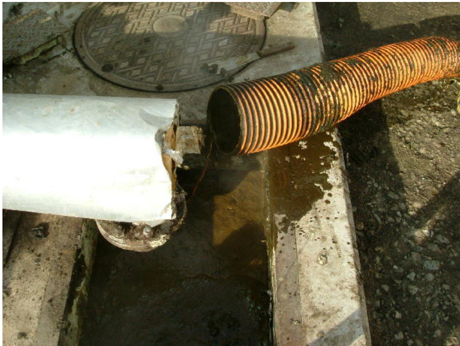
ホースがちょうちんのようにふくらみ、スパイラル状に途中でちぎれている。
