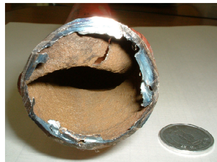
図2 錆びて肉厚が薄くなった配管
