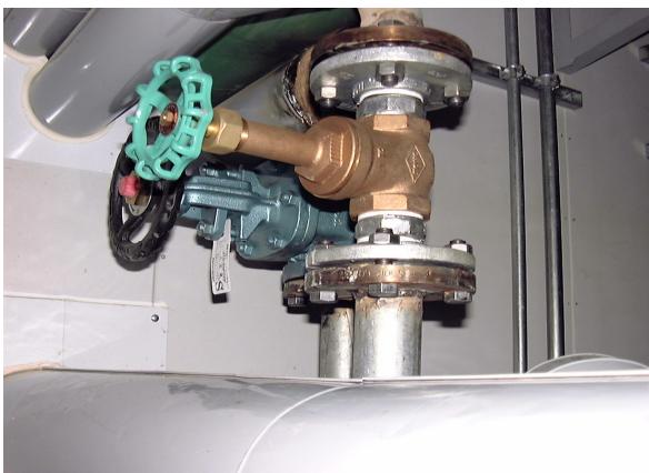
堆肥化施設への温水供給を停止するバルブ
