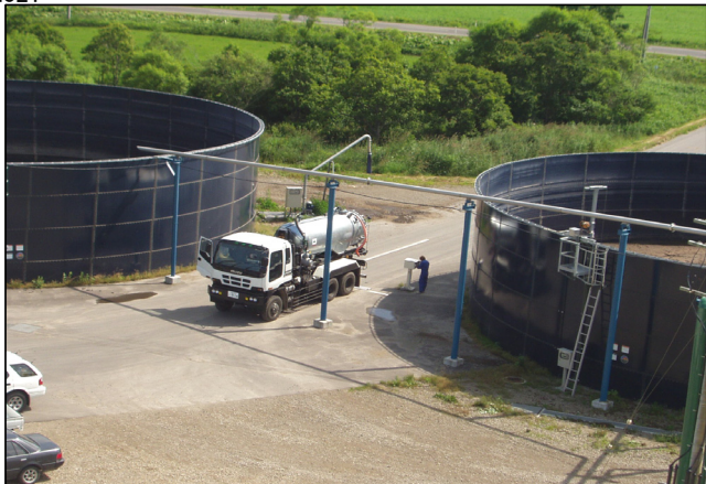
消化液貯留槽と汲み出しポンプ
