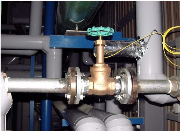
温室への温水供給を停止するバルブその1
