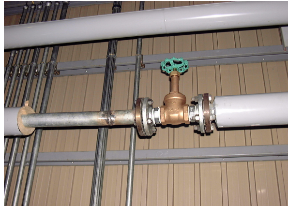
温室への温水供給を停止するバルブその2
