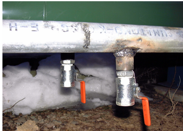
バルブを閉めたあとの配管内残留水を抜くためのバルブ。エアコンプレッサで加圧する必要がある。
