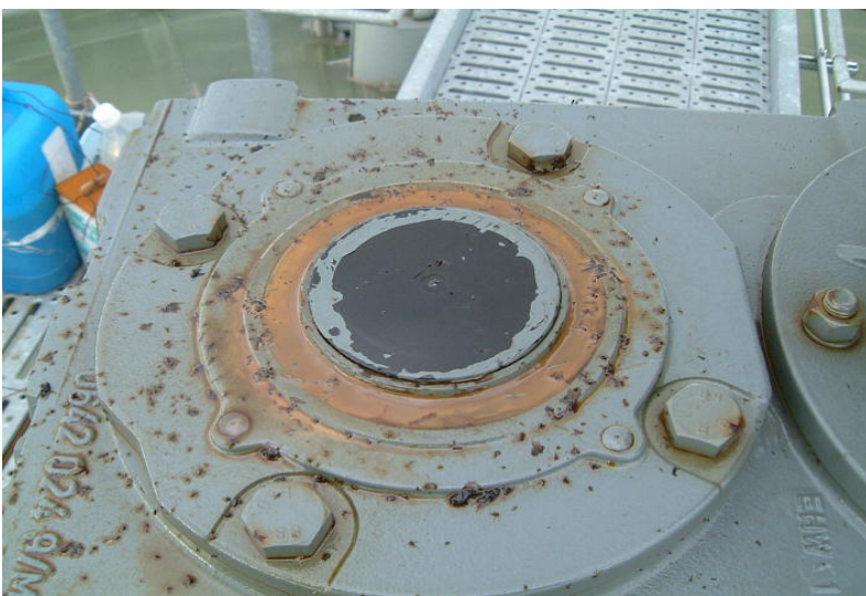
オイル漏れ状況の拡大写真。薄い茶色が漏れたオイルが乾燥した跡。
