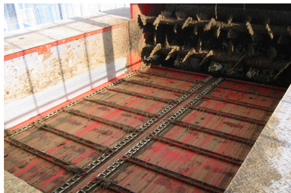
定量送り込み装置内部
