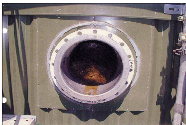
発酵槽との接続部で配管を取り外して、中を確認 配管の奥に閉塞物が見える
