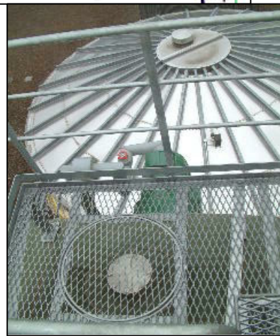
手前の小さなマンホールが追加設備した点検孔 奥は湿式ガスホルダーの屋根
