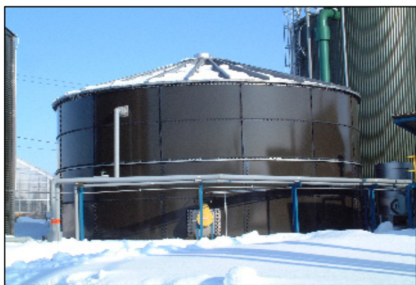
移設したガス流出口
