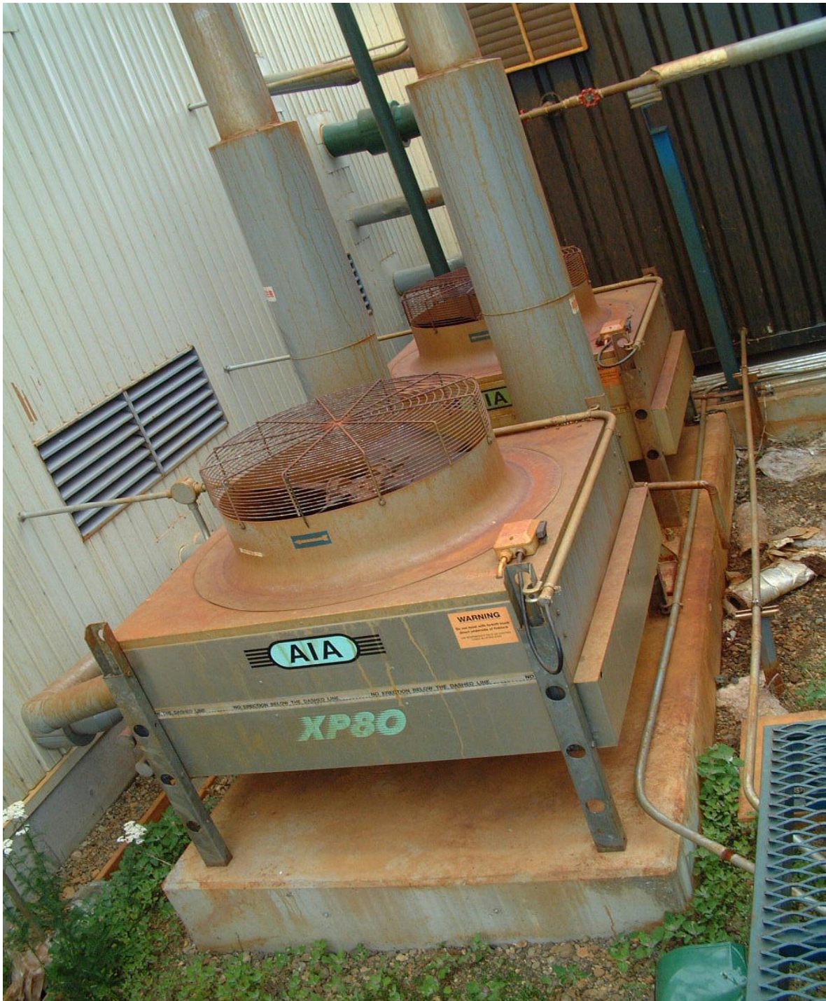
第3号コジェネレーターの冷却ファン
