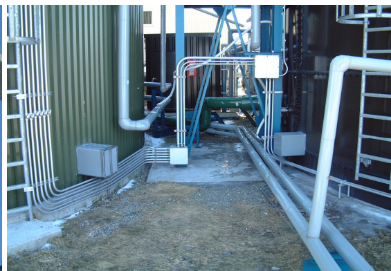
下部温度計(四角い箱で覆ってある)
