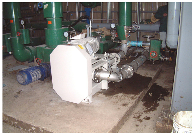
2005. 5. 10撮影 更新した兵神製モノポンプ
