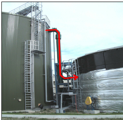
ガスと消化液の移送ライン
