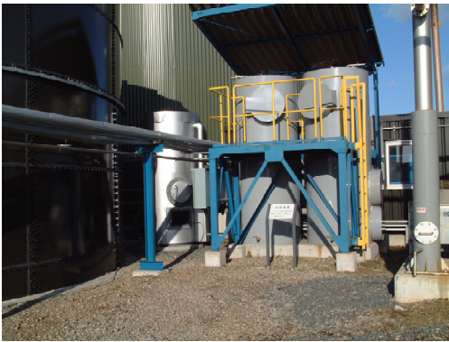
写真-34 2塔から構成される酸化鉄脱硫塔
