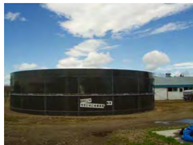
写真 1-2-6 グラスライニング鋼板槽
