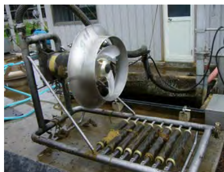
写真 1-2-3 散気管+攪拌機
