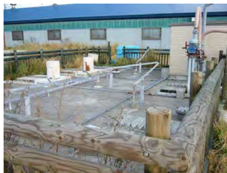
写真 1-2-2 コンクリート製地下埋設型の調整槽
