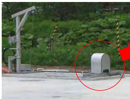
写真 1-2-4 消泡機（右側の写真が消泡機の本体）
