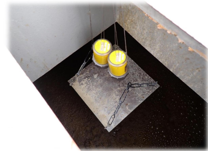
(調整槽内の硫化水素濃度の測定)
